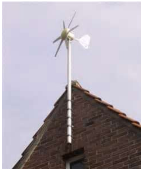
Beispiel: Kleinwindanlage am Hausgiebel
