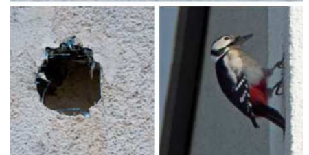
Vogelschäden an gedämmten Fassaden
