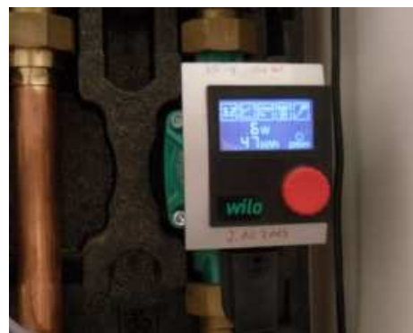
Effiziente Pumpen braucht das Land. 47 kWh Stromverbrauch in 11 Monaten Laufzeit.
