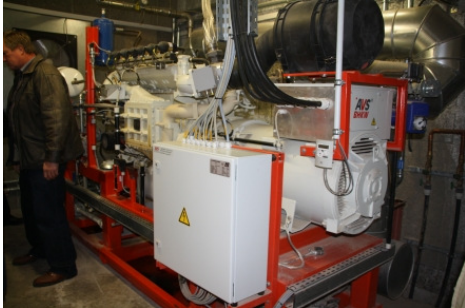
Das Blockheizkraftwerk. Das Herz der Strom- und Wärmeproduktion
